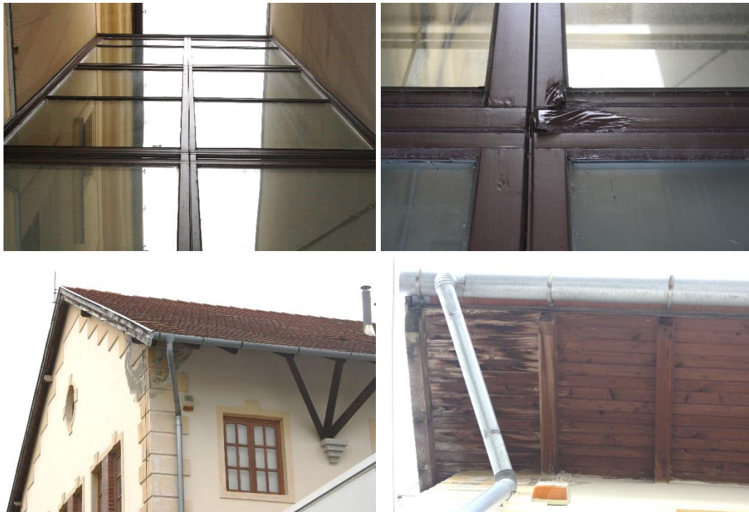
5. ábra Faszerkezetek károsodásának jelei szemrevételezés alapján
