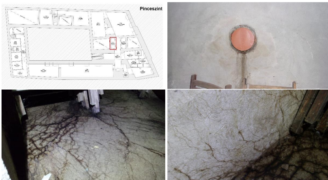
18. ábra Szivárgó szennyvízvezeték okozta lokális nedvesedés, gombafertőzés a pincében
